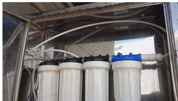
Mantenimiento de filtros del sistema de agua.
