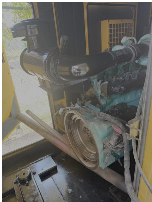
Mantenimiento de la Planta Eléctrica
