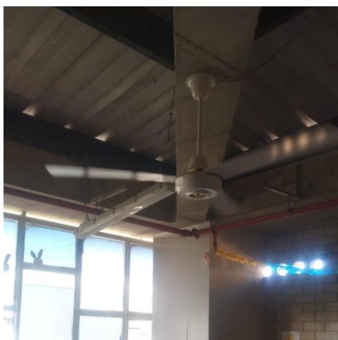
Ventilador instalado en aula de clase.
